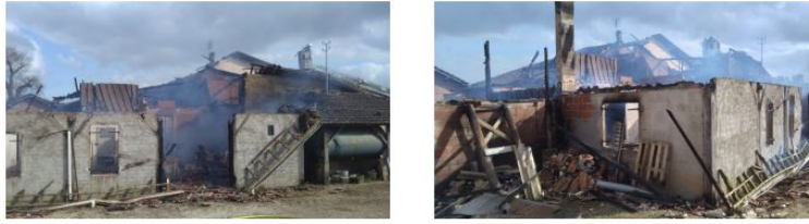
Deux bâtiments détruits par un incendie
