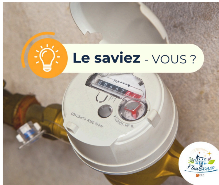
Gel : attention aux fuites d'eau
