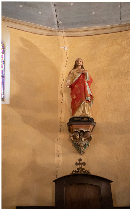
Fissure à l'intérieur
