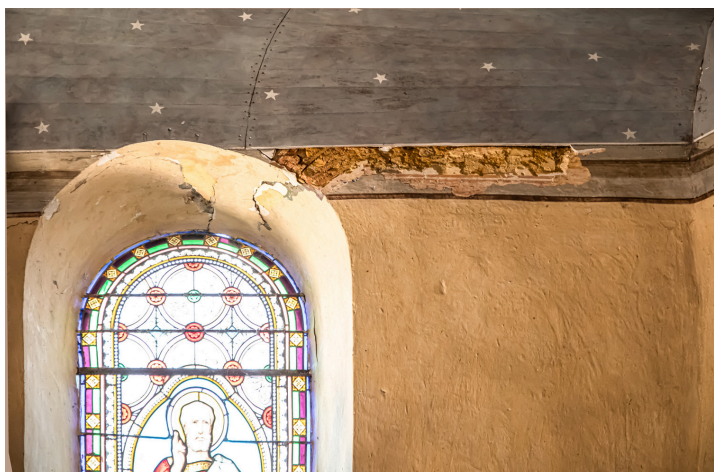
Dégâts à l'intérieur
