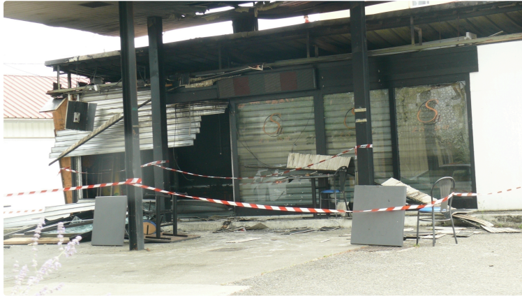
Un incendie détruit totalement un bâtiment commercial de 90 m2
