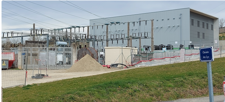
Visite inédite du poste électrique !
