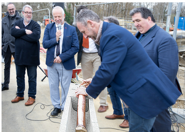
Johann Francke insère les dessins dans le tube qui être enfoui dans le béton
