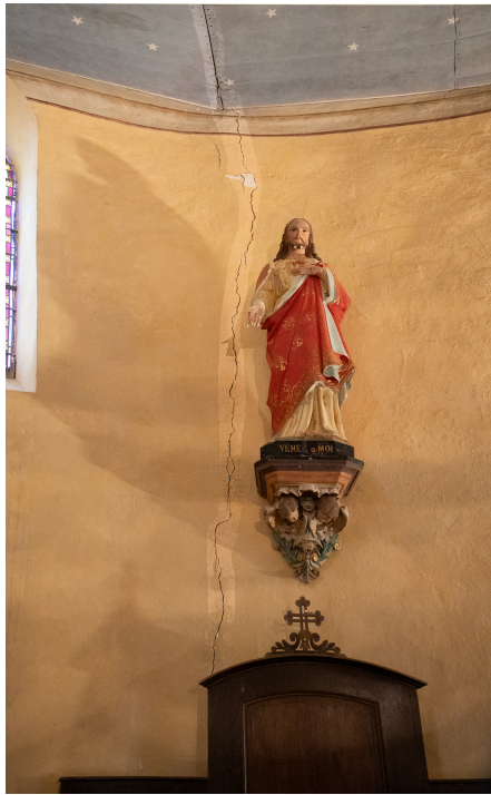
Fissure vue de l'intérieur
