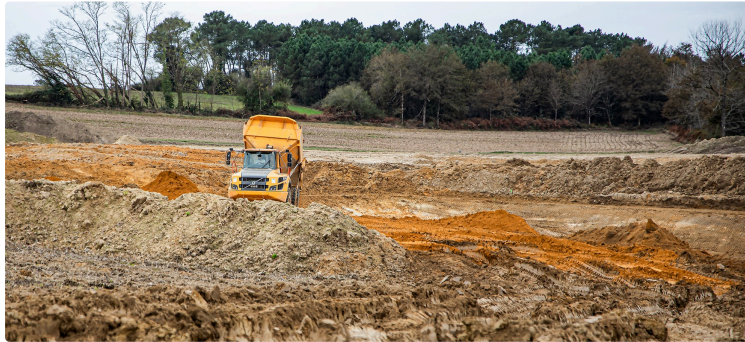
Toujouse : le préfet visite la retenue d'eau de la Tuilerie en cours d'agrandissement
