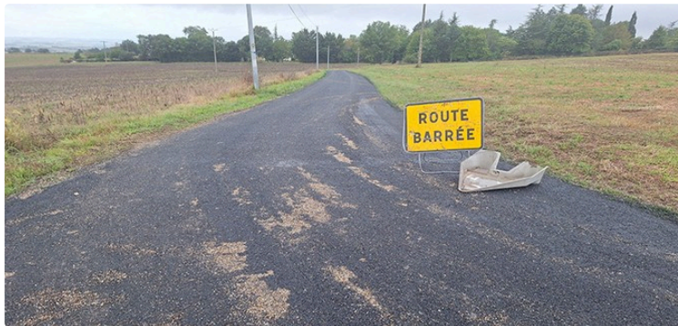
Dégradation de la voirie des actes incompréhensibles qui coûtent cher aux contribuables.
