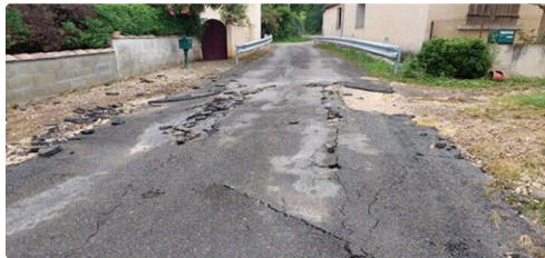
pompiers orages 963 .jpg
