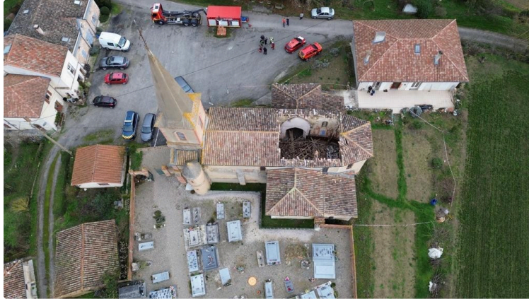
Suite à l'effondrement de la toiture de la nef de l'église, un périmètre de sécurité a été élargi
