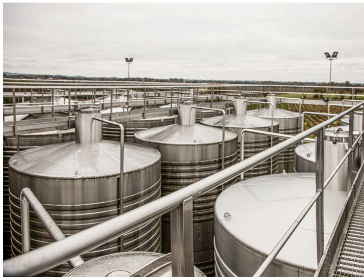
Tout en haut des cuves
