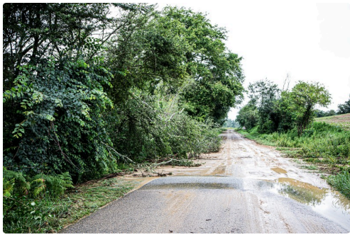
Dégâts ur la route Aignan - Nogaro
