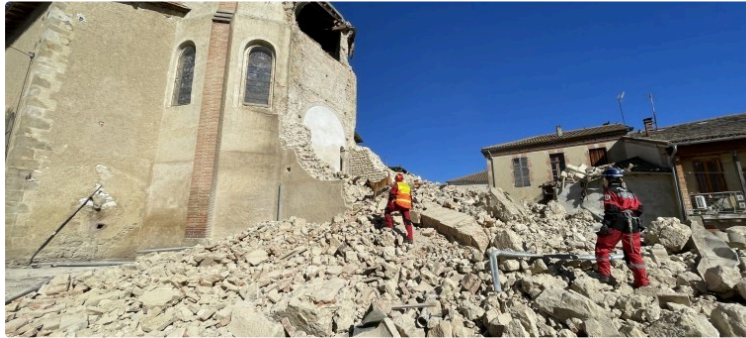
Après l'effondrement de la tour Saint Victor de l'église de Saramon ...
