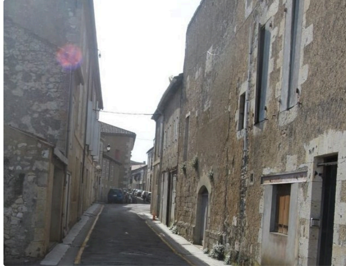
Lecture: le mur d'un immeuble situé rue Jules de Sarda en cours d'effondrement
