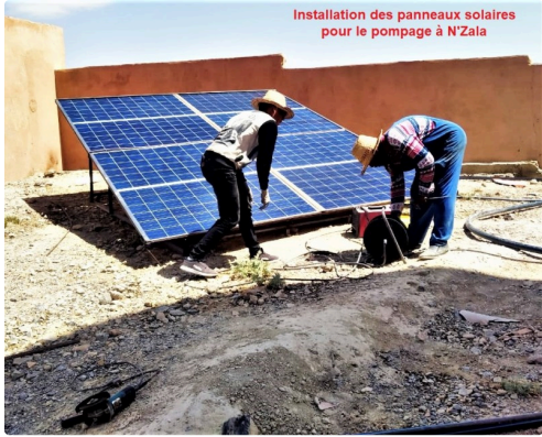
Panneaux solaires N'Zala.
