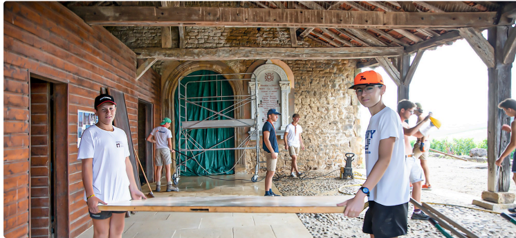
Ça bouge à Pouydraguin ! Travaux à la mairie et à l'église (avec des scouts) et fête du village
