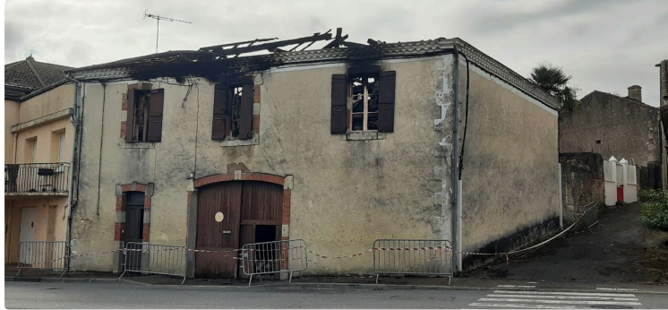
Une maison détruite par les flammes
