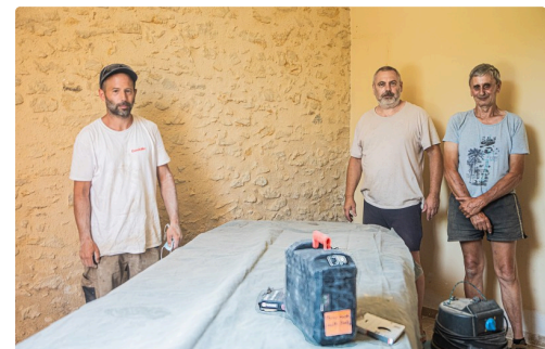
La salle de réunion en travaux avec Bertrand Priouzeau et Gérard Fitan le 15 juillet
