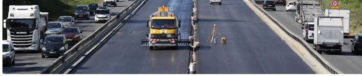
Travaux sur la RN124 entre les échangeurs d'En Jacca et de Pujaudran du 18 juillet au 12 août 2022
