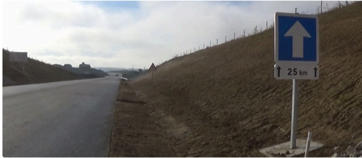
RN 124, déviation de Gimont : la fin des travaux pour le 1er trimestre 2022 ça se précise
