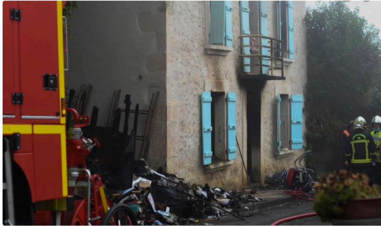
Deux maisons détruites par un incendie
