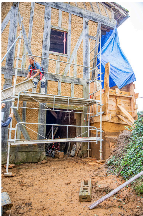
L'échafaudage sur la façade nord permet de monter la terre à droite
