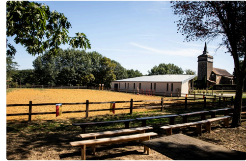
Vue du stade de joute en chantier à la Tour de Termes
