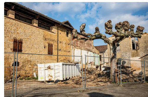
Maison détruite (côté rue du Sol)
