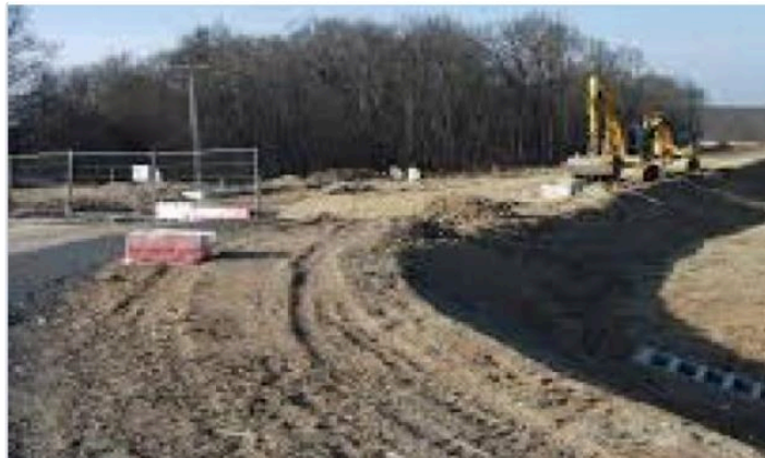
RN 124 : des crédits supplémentaires pour le chantier de la déviation de Gimont
