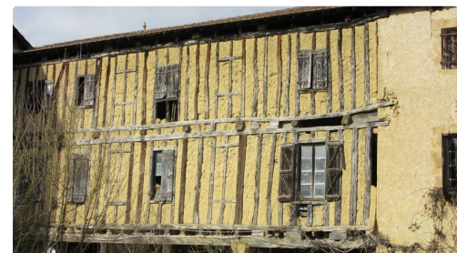
l'ancien moulin du pont
