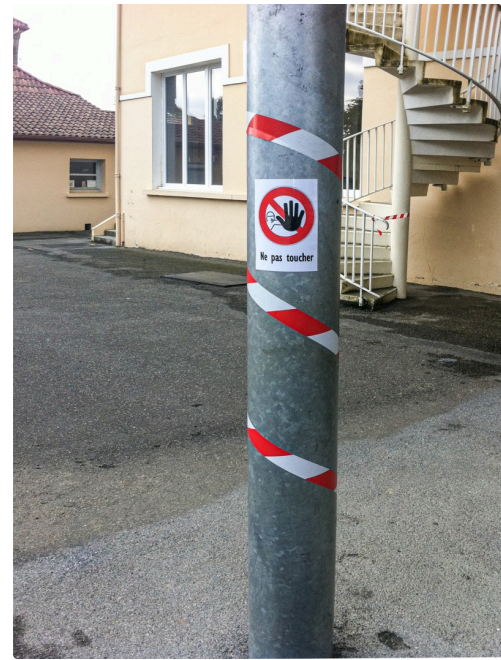
Poteau à ne pas toucher dans cour de l'école
