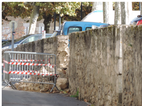
L'urgence des travaux est une réalité
