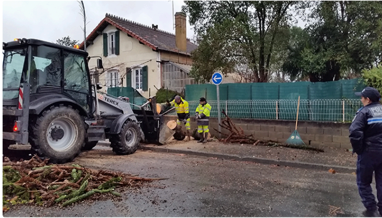
Des dégâts matériels sur la sous-préfecture
