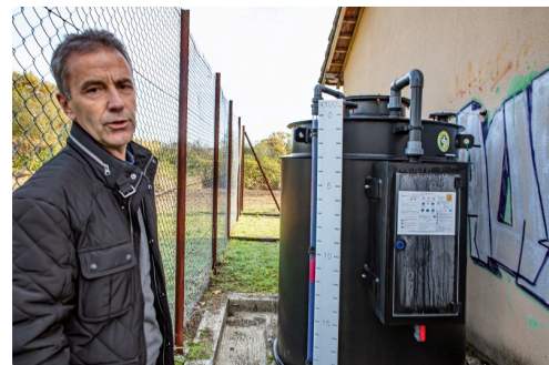
Le redresseur de pH traite l'eau avant sa consommation
