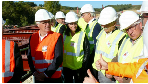
Les personnalités à l'écoute des explications sur le fonctionnement de la mise en place du 2ème tablier.
