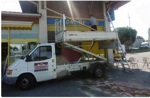
Une fermeture provisoire urgente en attendant de refaire la façade
