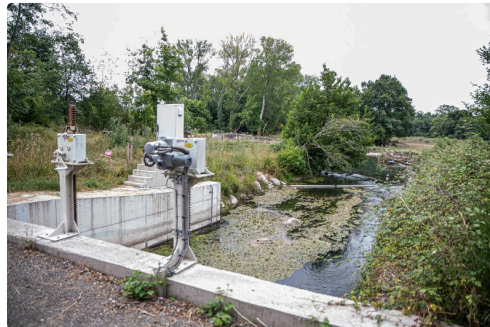
Les vannes du site des Charrutots
