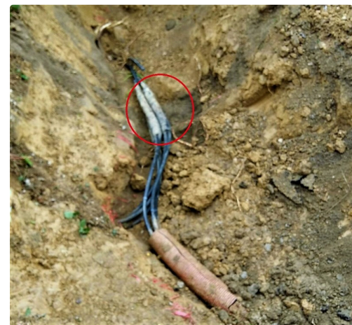
Le câble en cause - Photo Enedis
