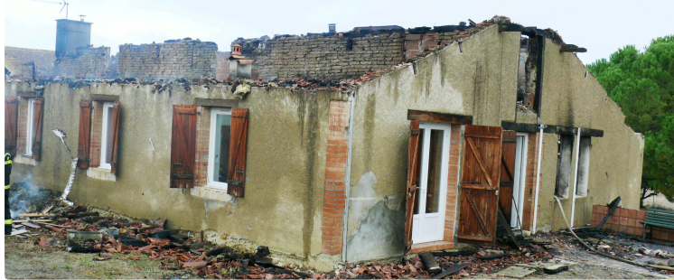
Un incendie embrase totalement une maison d'habitation
