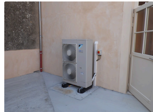
La climatisation posée sera à l'abri des convoitises
