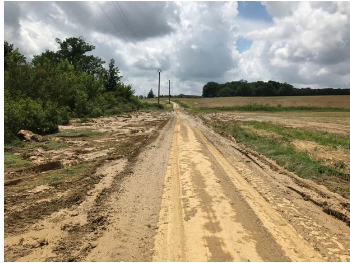
La voirie gravement endommagée
