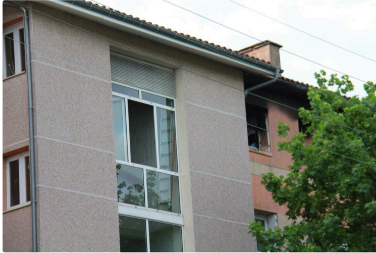
suites incendie appartement avenue Claude Augé
