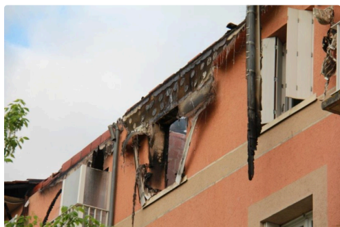
arrière de l'appartement qui était en feu
