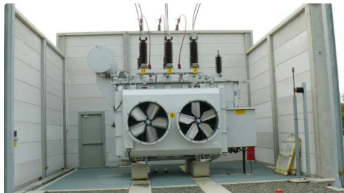
Le 19ème poste source du département, un énorme transformateur électrique.
