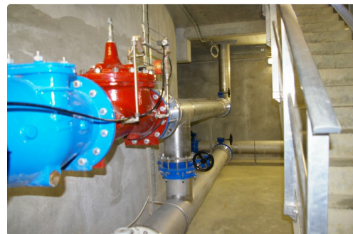
La vanne noire ouverte l'eau d'Aquitaine est passée dans le réseau d'Occitanie
