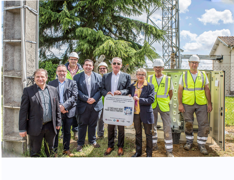
Nogaro – Des armoires pour le très haut débit avec la fibre optique
