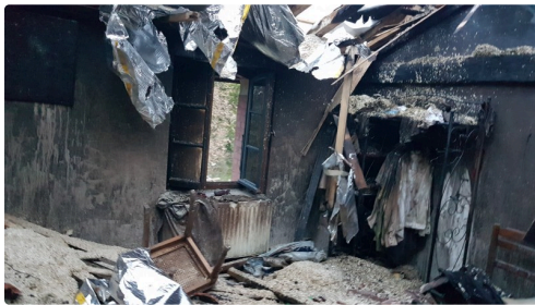
la maison sinistrée
