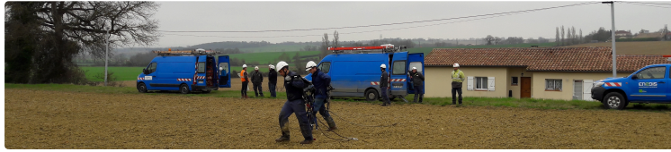
Sainte Radegonde : Enedis modernise le réseau 20.000 volts
