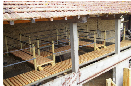
Les aménagements nécessaires au tri des bécérras
