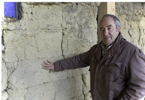
Jean Duclavé montre le mur de terre face au mur écroulé
