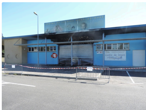
Une entrée détruite par les flammes
