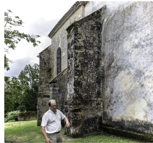
Le maire montre des travaux à faire
