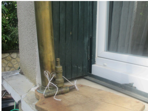
La 1ère pompe à main
